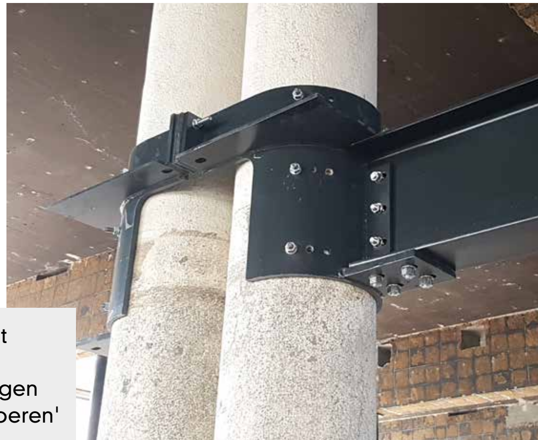
Klemconstructie voor de verankering van de nieuwe staalconstructie aan de bestaande kolommen.
